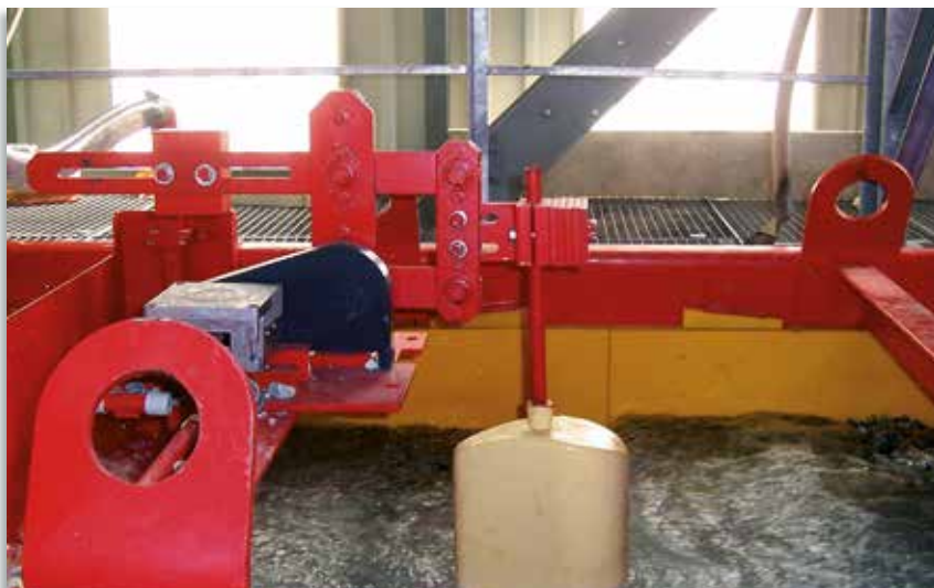
Резервуар с водой и плавающий переключатель
